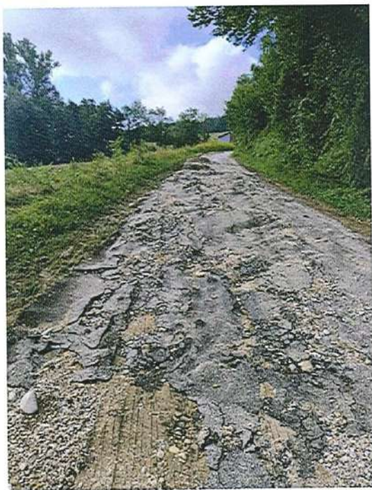
Inondations et coulées de boue route de Bachelin – août 2024
